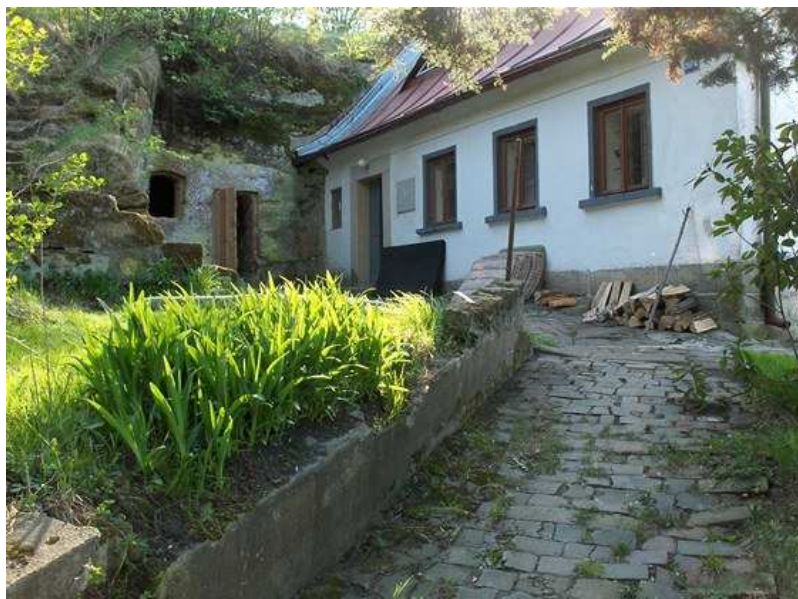
Zateplení kvalitní izolací musí být i na předstěně oddělující pokoje od části přilehlé ke skále. Vzniká tam totiž ohromná vlhkost.
